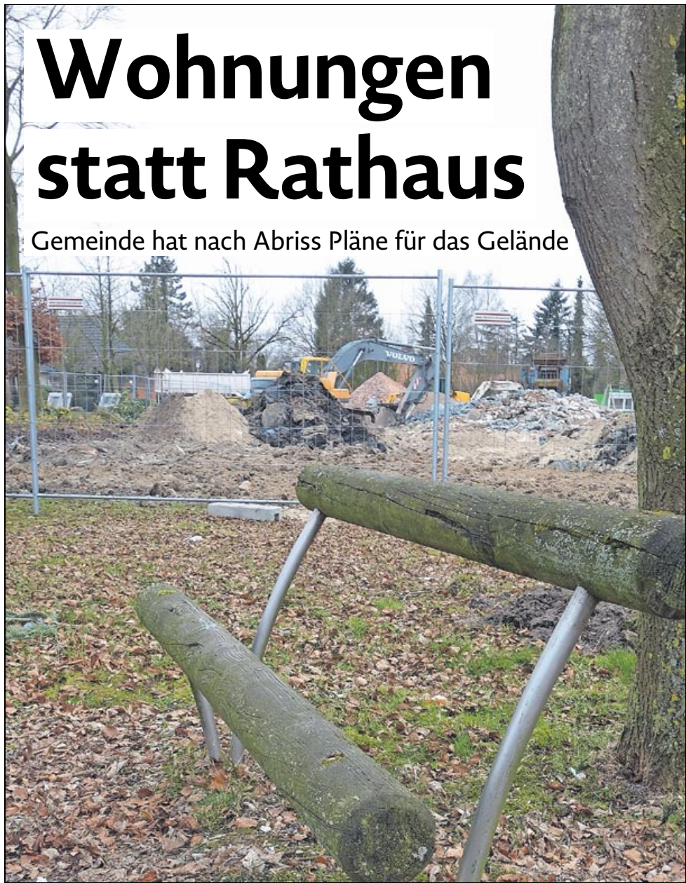
Wo einst das alte Rathaus stand, sind jetzt nur noch Schuttberge.
